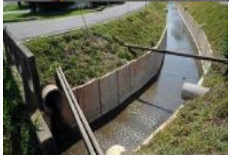
Drenagem e Manejo de Águas
